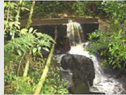
Captação 2 Bom Retiro Baixo
