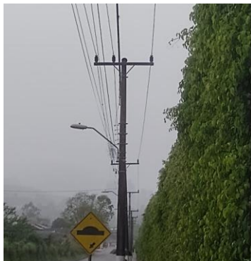
Parte Próxima a Fiação Elétrica
